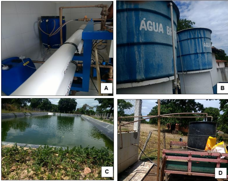
Figura 9 – Sistema de dessalinização de água da Comunidade Grossos
